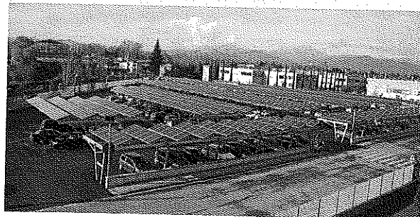
Un esempio di tettoia fotovoltaica: l'impianto realizzato da Enerray per la MST (Manifattura Sigaro Toscano) a Lucca. L'impianto in totale ha una potenza installata di 2.043 kWp di cui 216 su pensiline ed il resto sulla copertura dello stabilimento ed è in funzione dalla fine del 2008.
